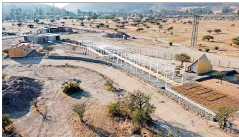
DESARROLLO. — El proyecto Parque Laguna Carén se ubica en un paño de más de mil hectáreas en Pudahuel, con el objetivo de ser un polo de investigación y docencia.
