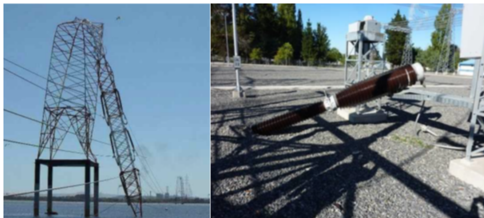
Figura 2: Daño en línea y subestación del SEN por terremoto, 27 Feb 2010.
